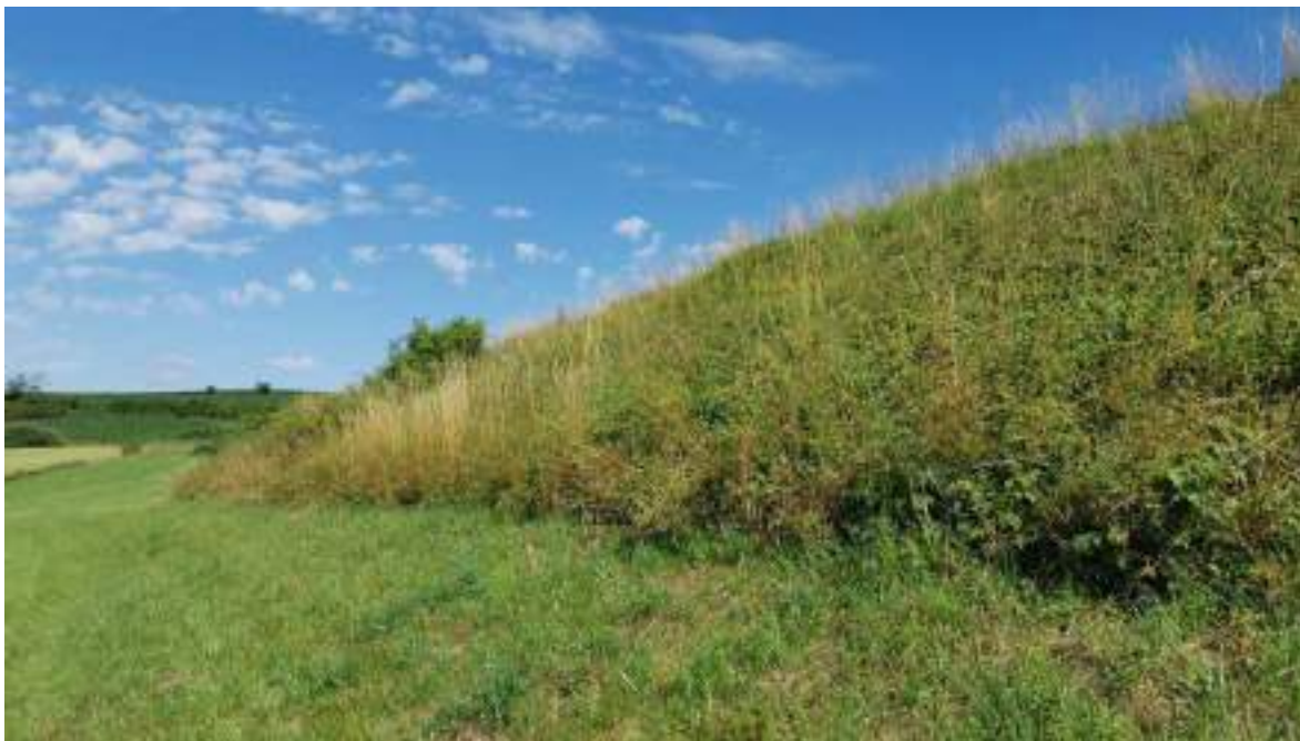
Die hohe Böschung im südlichen Plangebiet wird nicht mit Modulen überstellt. Hier hat sich eine Ruderalvegetation mit beginnender Sukzession entwickelt. Bei regelmäßiger extensiver Mahd und Aufgabe der Düngung der umgebenden Flächen kann sich eine magere Wiese entwickeln (Maßnahme M7).
